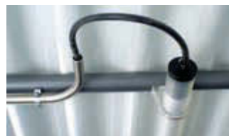
▲ Leerrohrsystem für Leuchtenverkabelung: Edelstahl, rostfrei, für elektrische Leitungsführung (z. B. NYM-J 3 x 1,5 mm²) inkl. Befestigungsmaterial (ohne Verkabelung)
