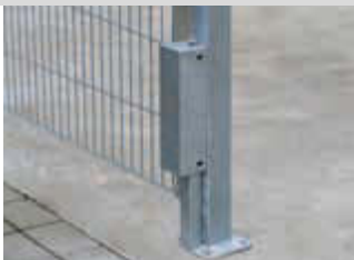
▲ Detail: Anschlusskasten mit Blechummantelung
