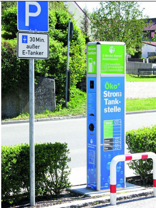
Stromtankstelle COLOM mit Werbeaufsatz und Folienbeklebung
